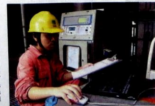
Der Rollwagen gehört zum mobilen Messsystem. Mit seinen Geräten lassen sich die Anteile von Sauerstoff, Kohlendioxid und Stickoxiden in den Rauchgasen analysieren.
