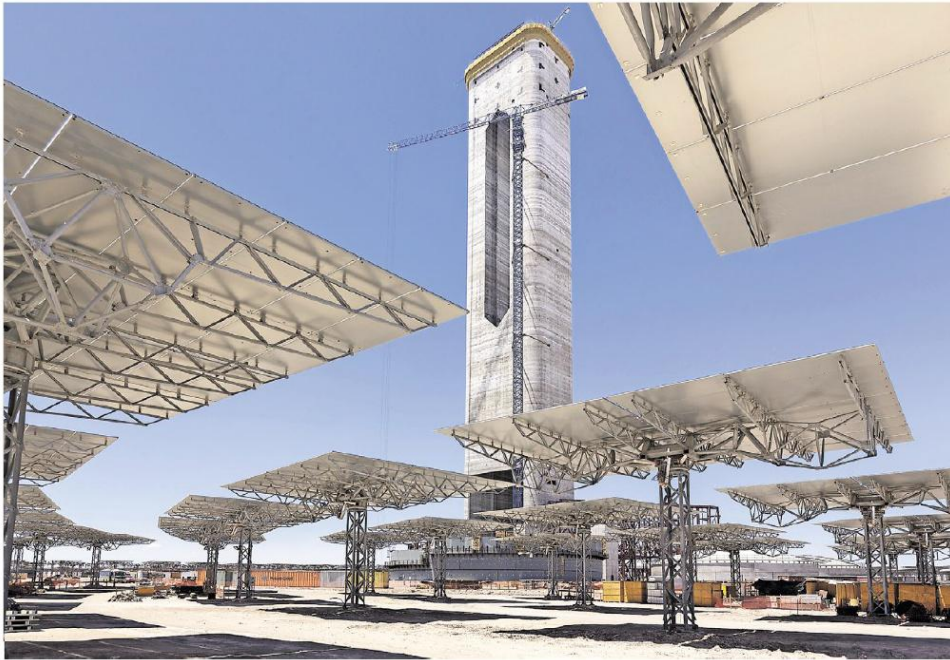
Derzeit stehen die Kräne still, doch bald schon soll an der gigantischen Solarenergie-Anlage in Chiles Atacama-Wüste weitergebaut werden: 210 Meter hoch ist der Turm, auf dessen Spitze dann 10.600 jeweils 144 Quadratmeter große Spiegel die Energie der Sonne fokussieren sollen.
